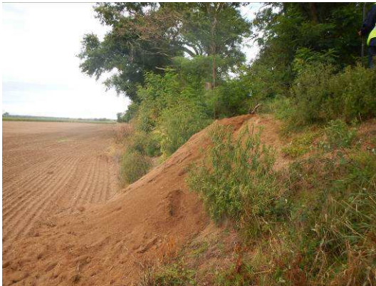
Figure 11 : pied de talus coté val vu vers l'aval avec terre déposée issue d'un grand terrier
