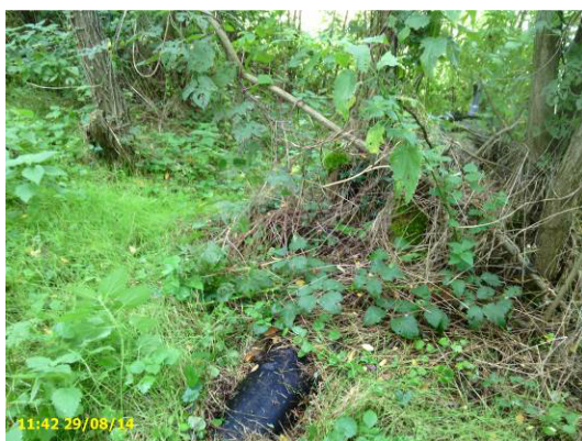
Point 349 : canalisation PVC apparente en crête (disparaissant vers crête coté Loire)
