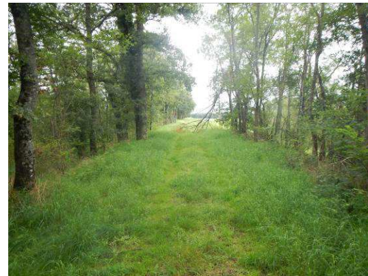
Début d'un tronçon de végétation ligneuse généralisée sur talus coté val (vu vers l'amont – tronçon n°2)
