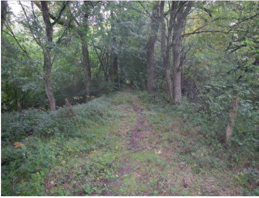
végétation ligneuse généralisée sur la crête et les 2 talus au niveau du tronçon n°1 (vue vers l'aval)
