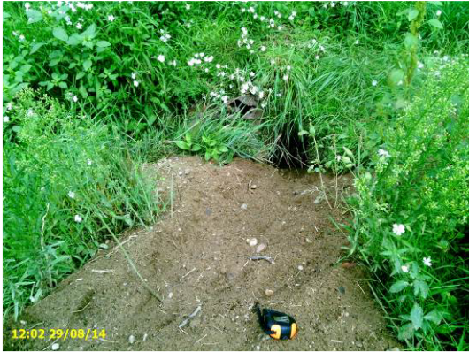
Terrier diamètre supérieur à 15cm – talus val sur tronçon n°2
