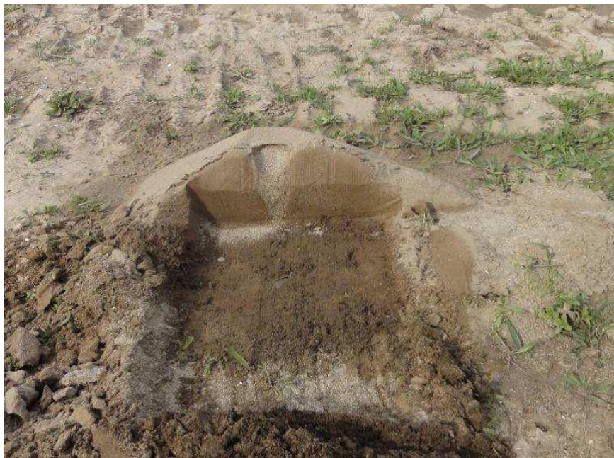
Figure 53 : Coupe d'un sand Boil derrière les digues de l'Agly - crue du 6 mars 2013 - (photo : DDT des Pyrénées-Orientales)
