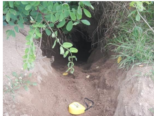
Figure 16 : terrier avec diamètre supérieur à 15cm sur talus côté val
