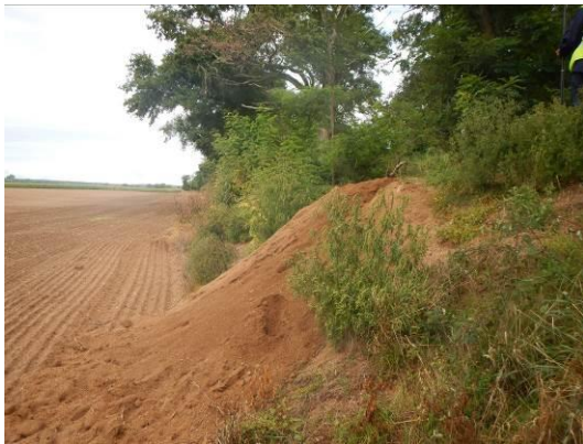
Figure 17 : pied de talus côté val vu vers l'aval avec terre déposée issue d'un grand terrier
