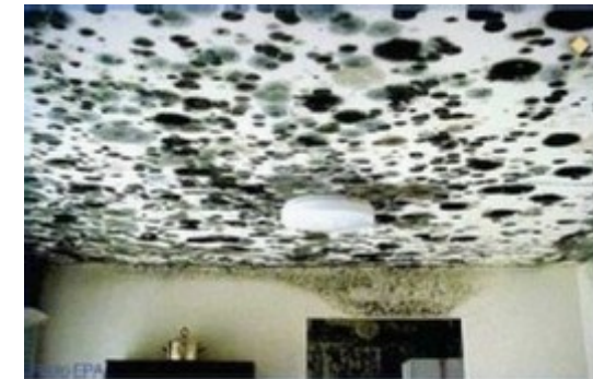
Dégâts sur le bâti
