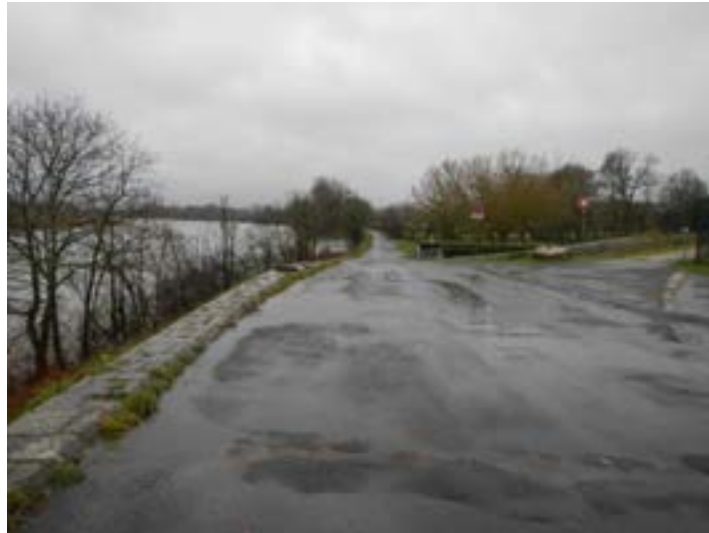
Figure 62 : Absence de franc-bord au droit de l'ancienne écluse de la Jonction (Egis Eau, 2014)
