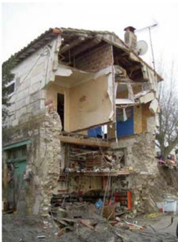
Figure 74 : Destructuration d'une maison à Fourques (source : CETE méditerranée)
