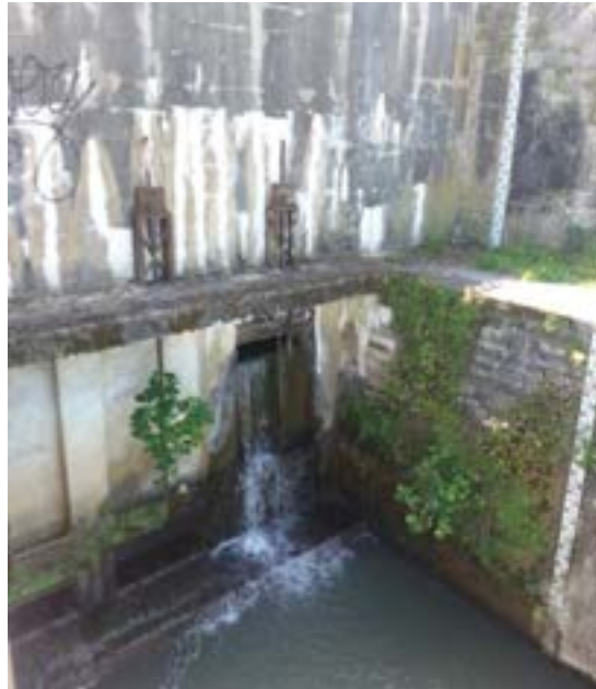
Figure 54 : Vannes au niveau de l'ancienne écluse de la Jonction
