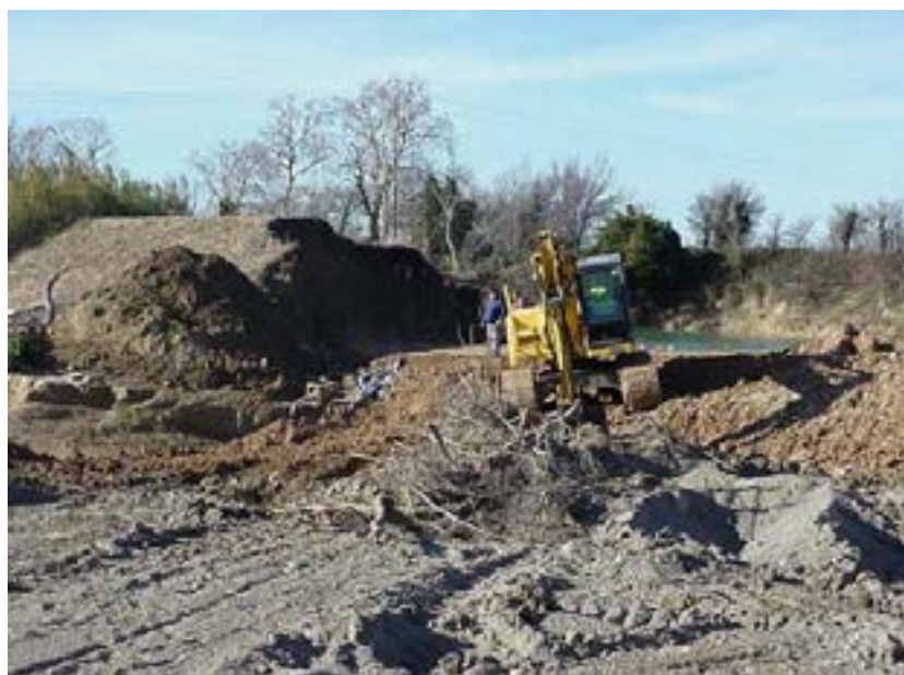
Figure 75 : Brèche sur la digue à Saint-laurent-d'Aigouze (source : CETE méditerranée)
