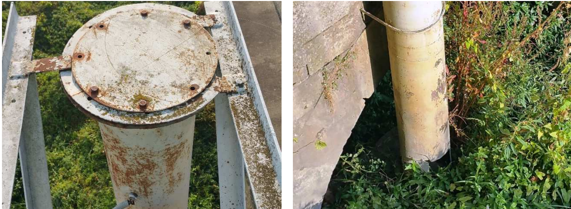
Figure 7 : Etat - Capteur de niveau aval
