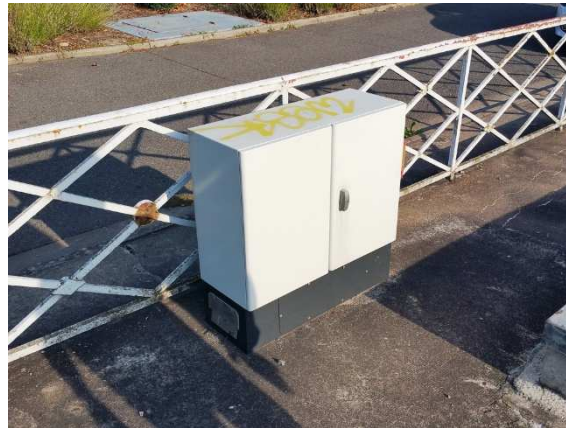
Figure 9 : Description - Coffret extérieur pour groupe électrogène
