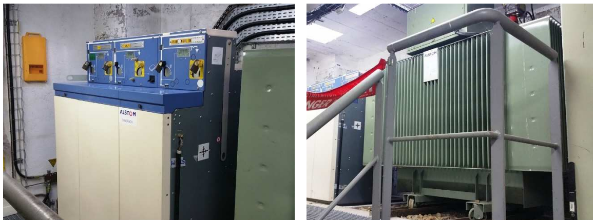
Figure 8 : Description - Equipements poste de transformation
