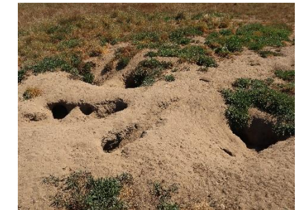
Trous au sein de la partie C Source : ARTIFEX 08/2022
