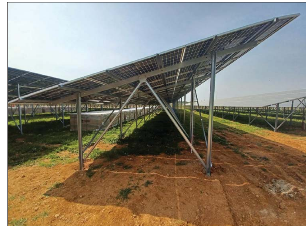
Figure 15 : Exemple de table photovoltaïque laissant passer les eaux de pluie entre les panneaux (éléments)
