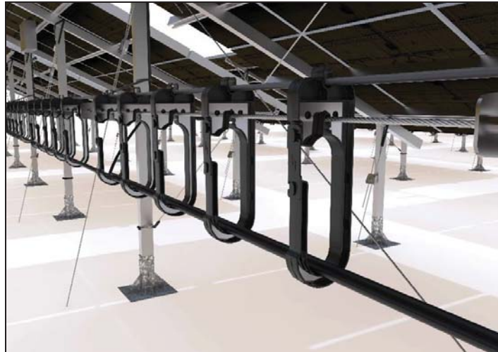
Figure 14 : Exemple de réseau de câbles hors-sol : suspente de câbles au niveau des tables
