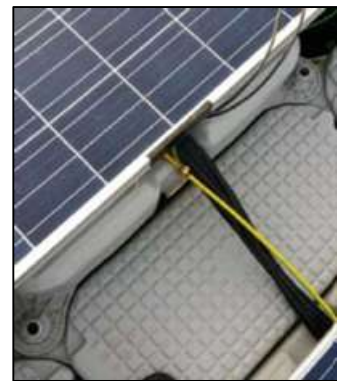
Passage des câbles (Source : CIEL & TERRE)
