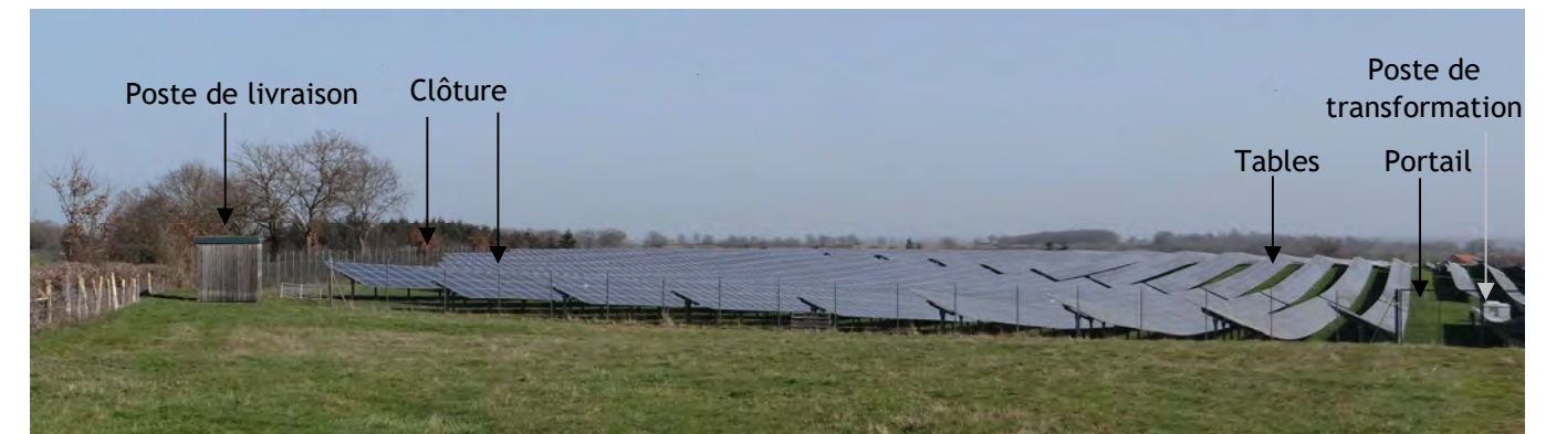
Figure 42 : Exemple de centrale photovoltaïque au sol existante avec poste de livraison et postes de transformation en vue immédiate dans un contexte bocager
