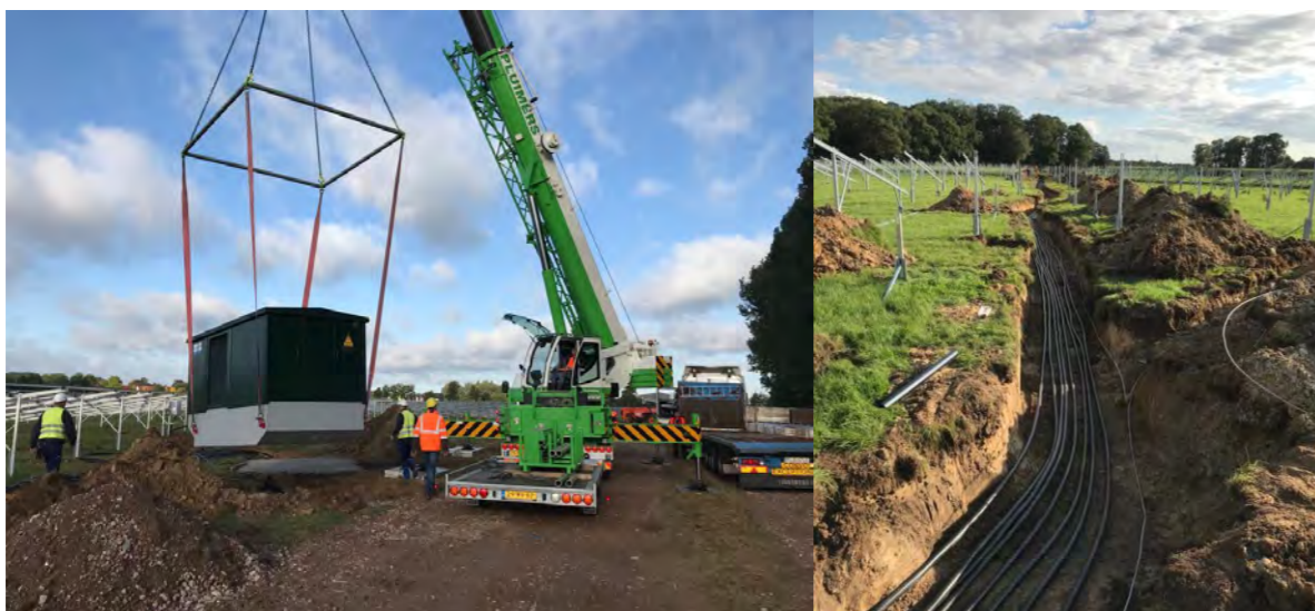
Figure 104 : Mise en place d'un transformateur (gauche) et tranchée pour le câblage interne à la centrale (droite)
