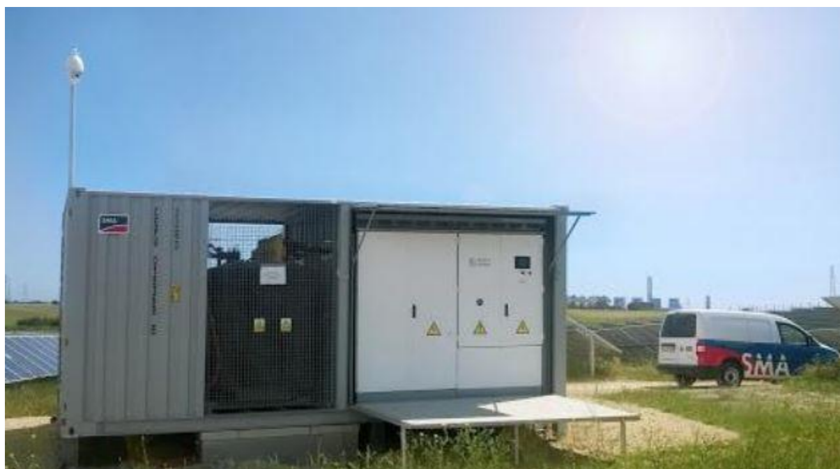
Figure 22: Exemple de poste de transformation
