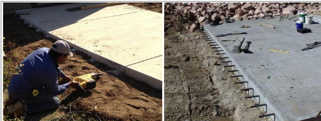
Figure 38: Percement de la dalle et mise en place des ancrages (Source : AVP – 2018)
