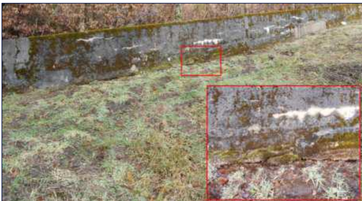
Figure 22 : Zoom sur les dégradations constatées (Source : VTA - 2017)
