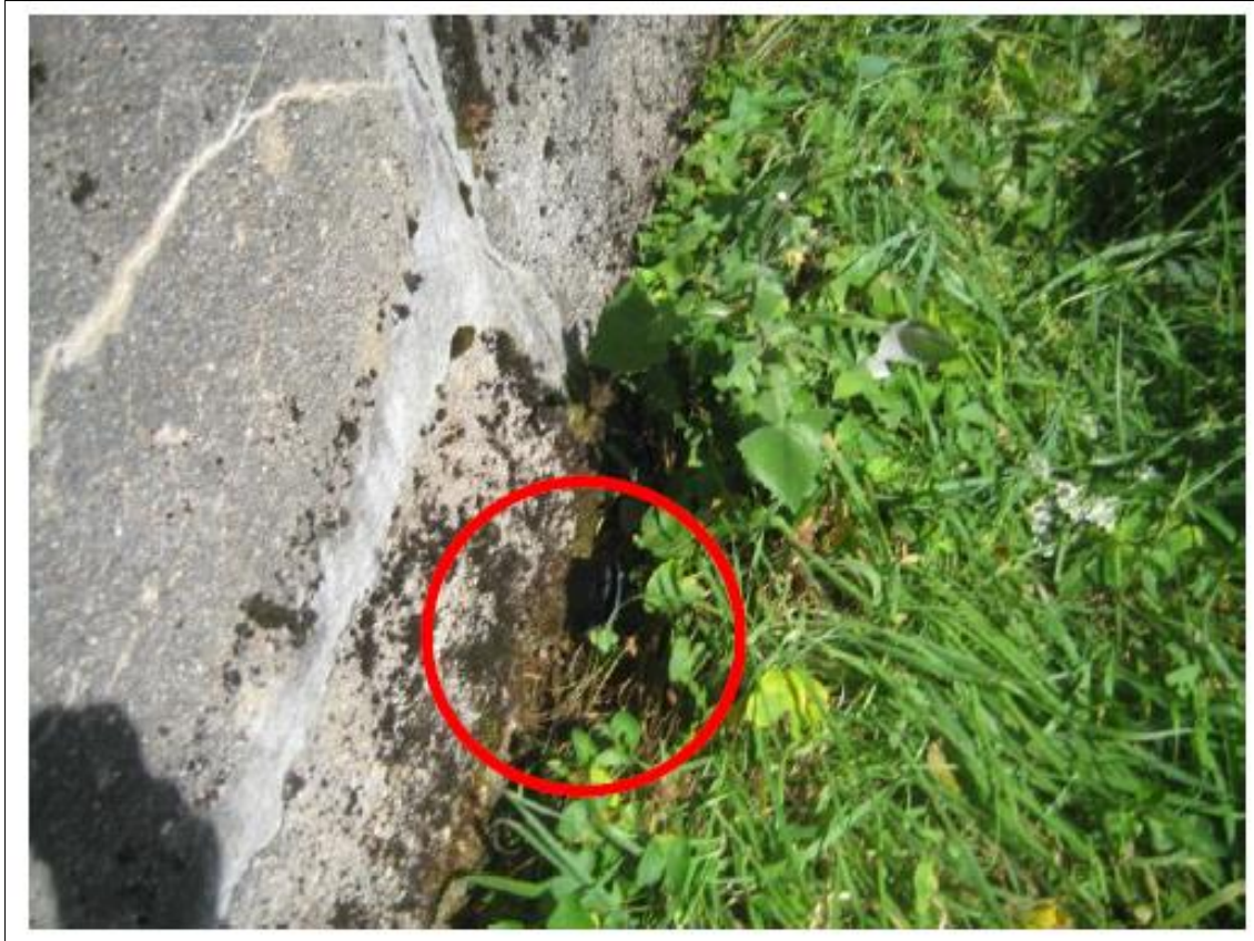
Figure 36: Cavités sous le coursier
