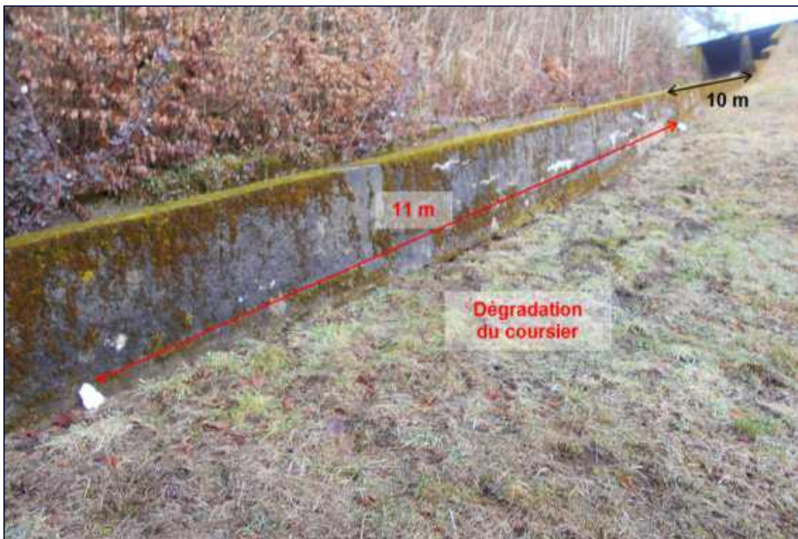
Figure 21 : Dégradation du coursier en pied extérieur bajoyer gauche (Source : VTA - 2017)
