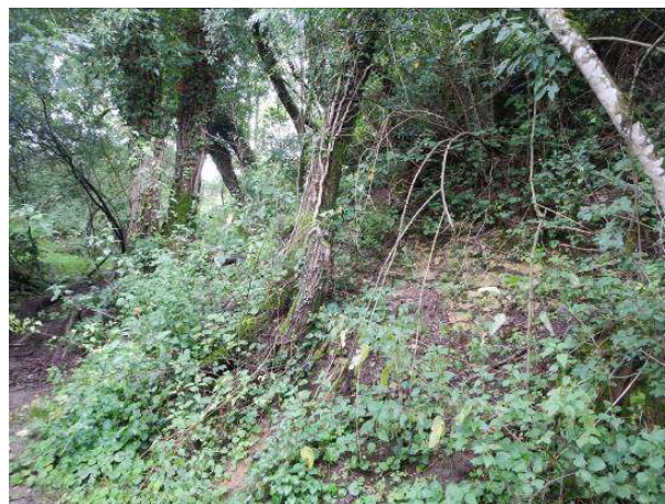
Talus perré au niveau de la fin aval de la digue de Charrin (tronçon n°5)
