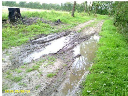
Figure 14 : ornières en amont du renforcement de la crête (vues vers l'amont)
