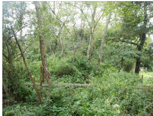
Végétation généralisée en aval du tronçon n°5 y compris en crête (vue vers l'aval)
