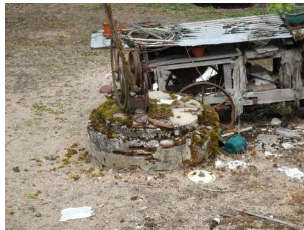
Puits en pierres pied de talus coté val vu depuis la crête de la digue (tronçon n°2)
