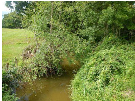
Figure 2 : fossé en eau en pied de talus coté Loire vu vers l'aval
