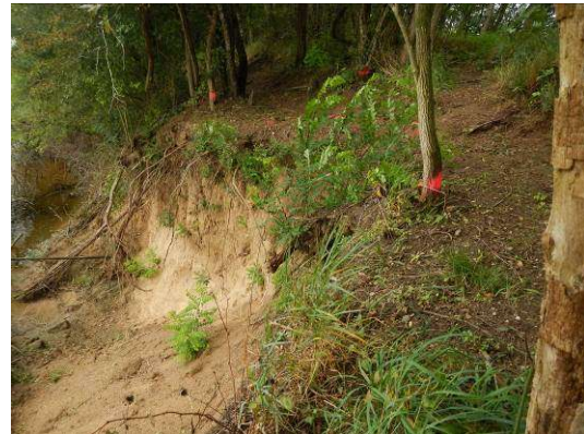
glissement important au niveau de la berge de la Loire (tronçon n°5) avec bas de talus verticalisé vers l'aval
