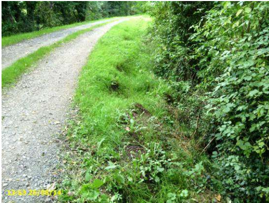
glissement superficiel sur le haut du talus coté val (tronçon n°1)
