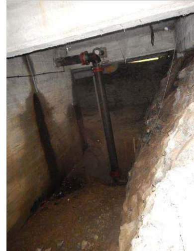
Canalisations sous bâtiment de la station de pompage (tronçon n°5)
