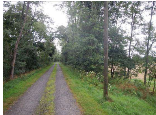
Figure 16 : végétation généralisée sur les 2 talus de la digue (vue vers l'aval)
