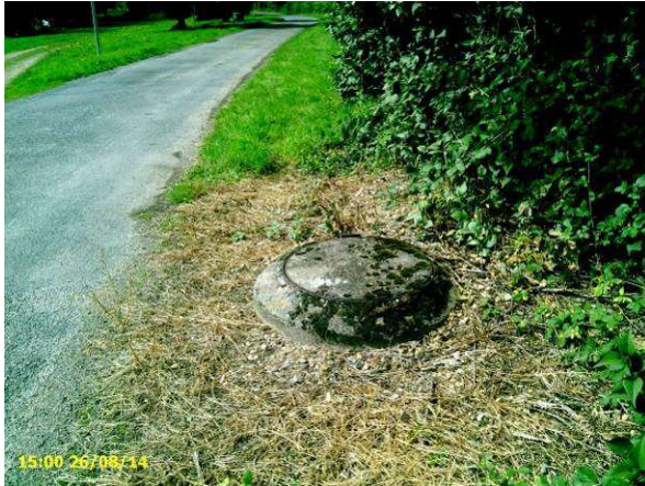
Tampon témoignant la présence de canalisation à proximité des habitations (tronçon n°2)
