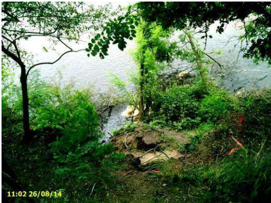
glissement important au niveau de la berge de la Loire (tronçon n°5)
