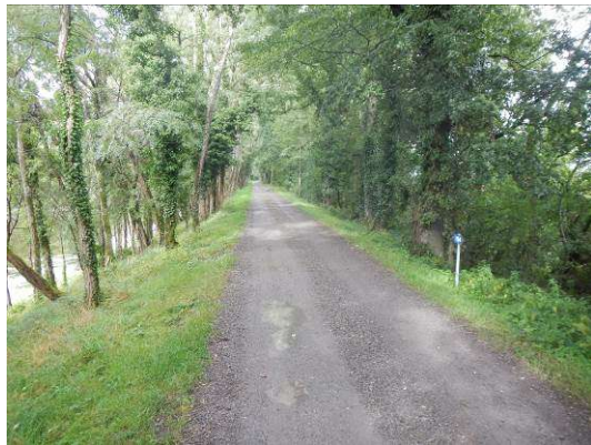
Végétation généralisée sur les 2 talus (vue vers l'aval - tronçon n°5)
