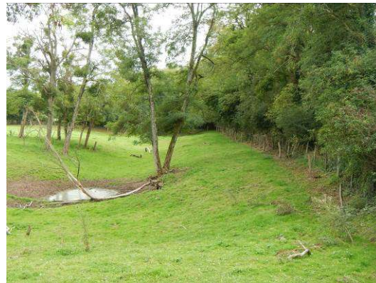
Petite dépression en eau sur le pied de talus coté val (tronçon n°3)
