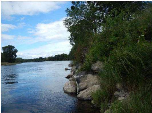
Enrochements libres au niveau de la berge de la Loire (vus vers l'aval - tronçon n°2)
