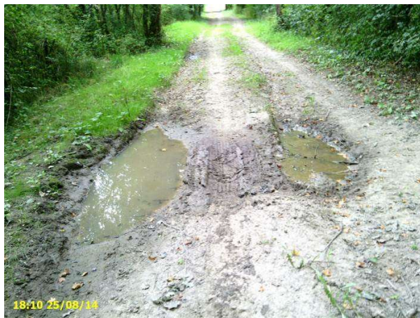
Ornière sur la crête vue vers l'aval
