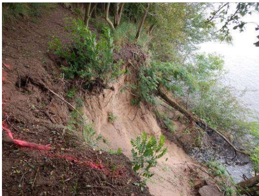
Figure 17 : glissement du talus coté Loire
