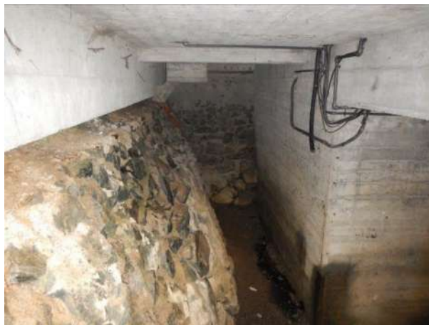
Vide sanitaire sous bâtiment de la station de traitement AEP avec renforcement des fondations en parement maçonné (tronçon n°5)
