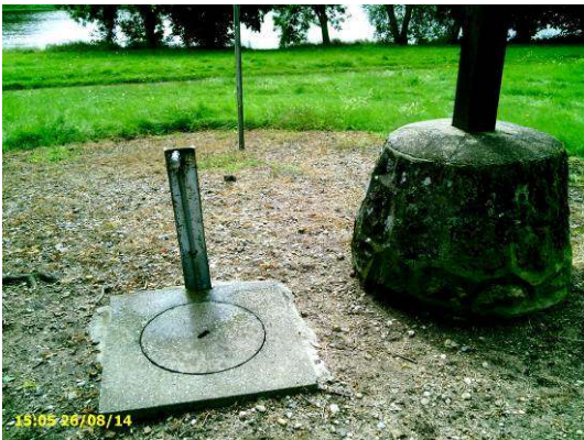
Figure 7 : corps étrangers sur talus coté Loire
