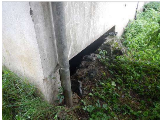
Vue de l'accès sous le vide sanitaire de la station de traitement AEP coté talus rive (tronçon n°5)
