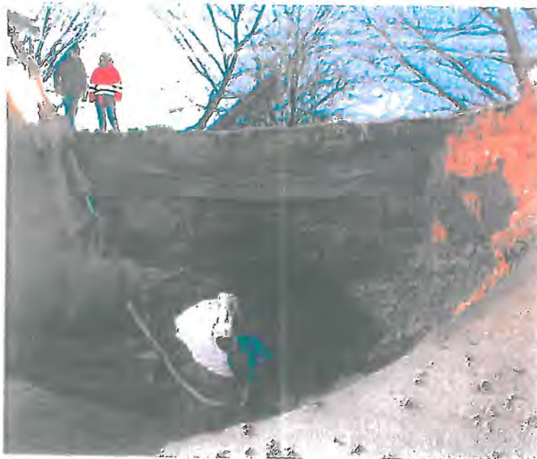
Illustration 9 : Galerie creusée à travers un ouvrage hydraulique par érosion interne
