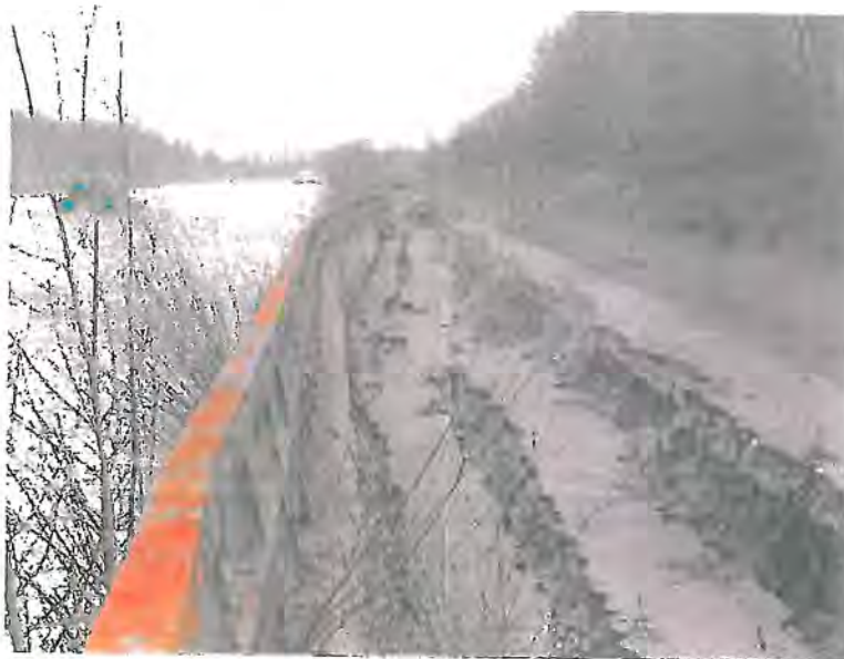
Illustration 10 : Niches d'arrachement successives d'un glissement affectant un pan de digue
