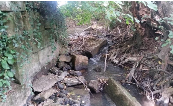
Figure 25: Ouvrages en ruine bloquant la continuité
