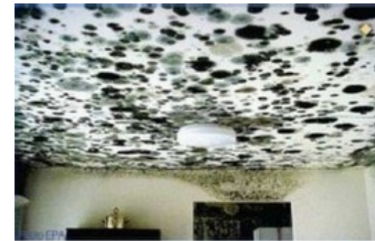
Dégâts sur le bâti
