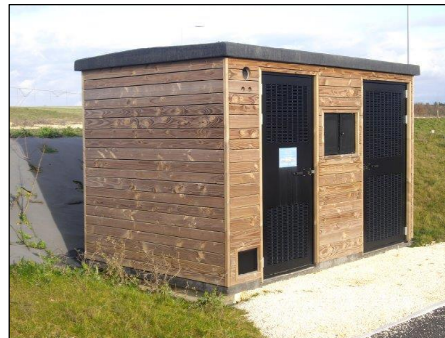
Illustration 16 : Exemple de poste de livraison
