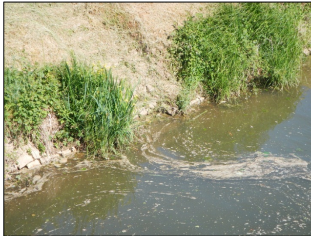
Figure 12 : Etat du perré en pierre sur le talus de la Jonction 3ème section (Egis Eau 16/05/2014)
