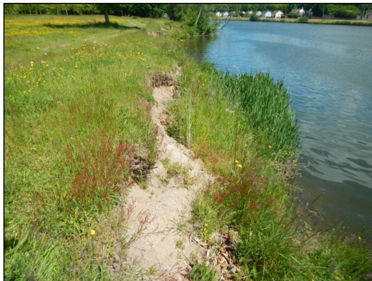
Figure 20 : Suite continue d'affaissement des berges en rive gauche -val de Decize (58) (Egis Eau 16/05/2014)
