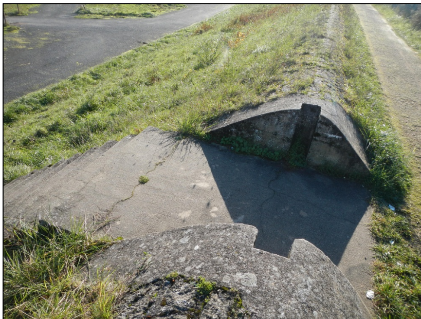
Figure 1 : Bouchure sur la levée du canal de la Jonction face à la piscine du canal – val de Nevers (58)
