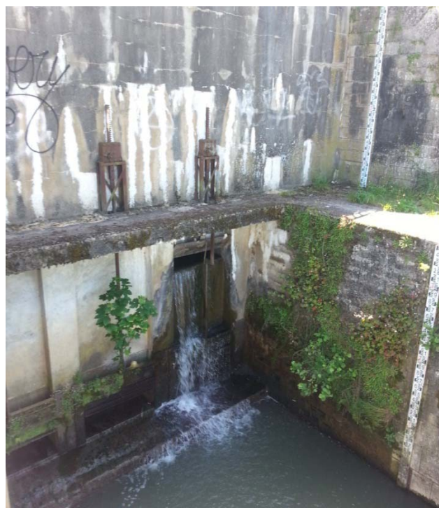
Figure 2 : Vanne côté Loire face à la piscine du canal - val de Nevers (58)
