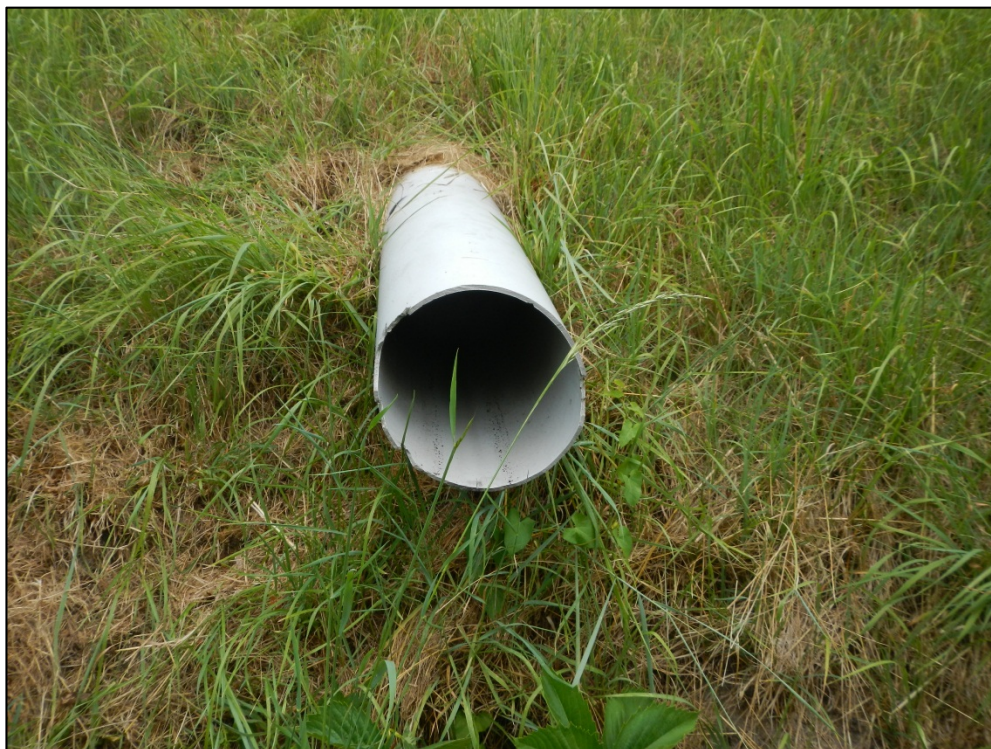
Figure 7 : Canalisation en PVC profil 92 côté Loire - val de Nevers (58)
