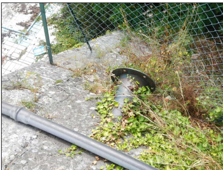
Figure 4 : Canalisation P63 côté val face à la piscine - val de Nevers
