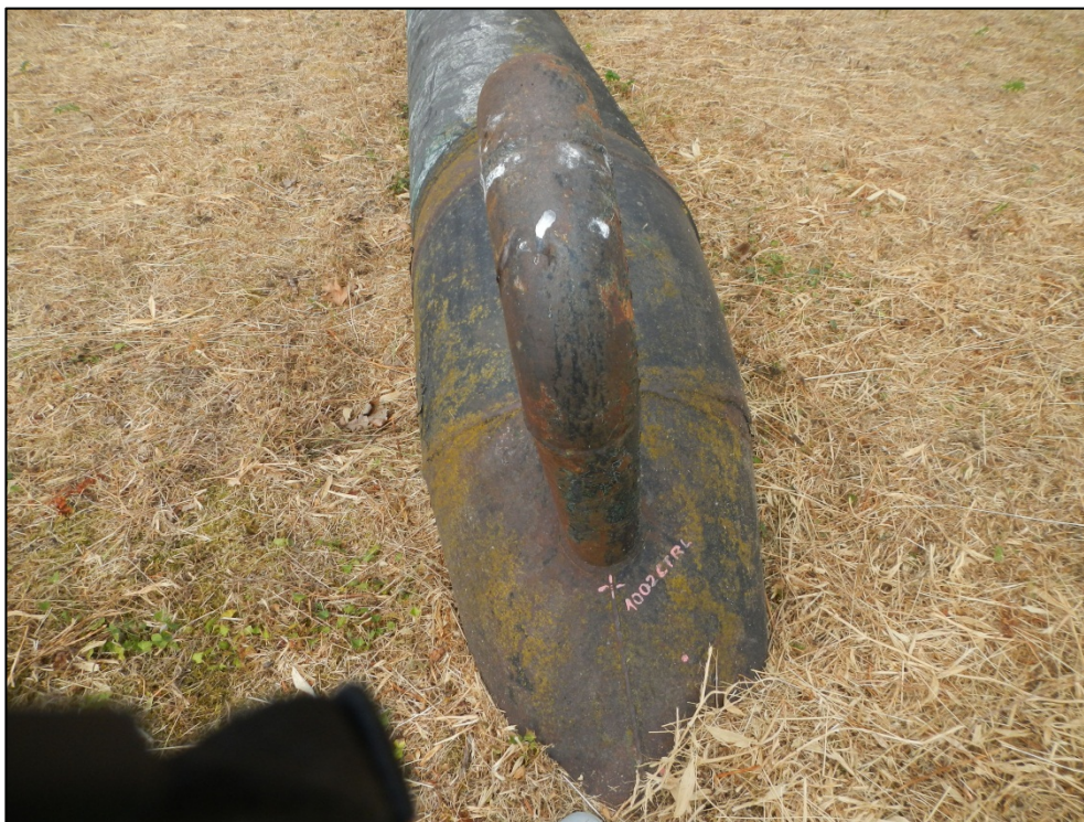
Figure 5 : Conduite côté Loire profil 82 - val de Nevers (58)
