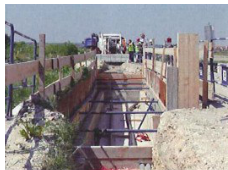
Chambre de jonction
