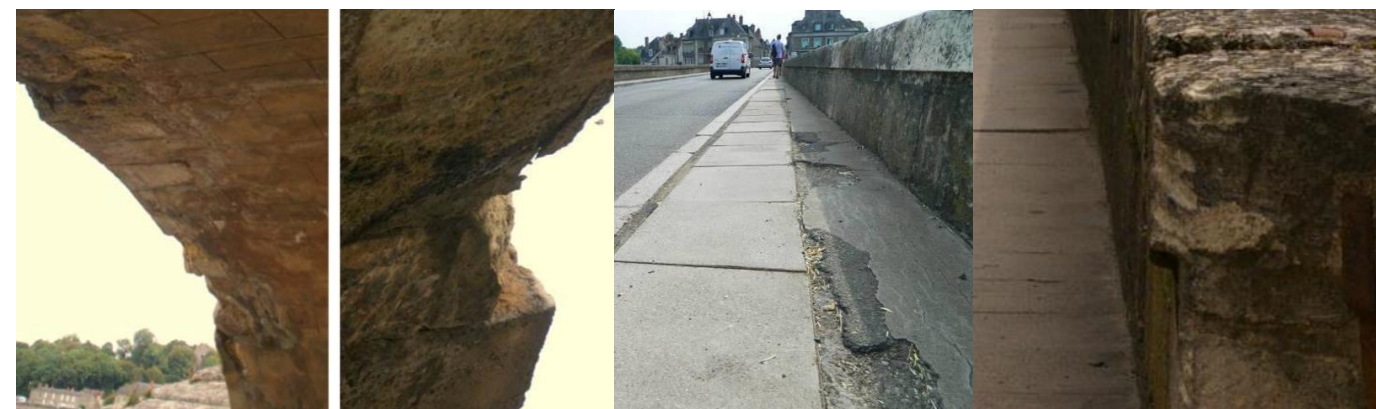
Exemple de désordres observés sur le pont de pierre
