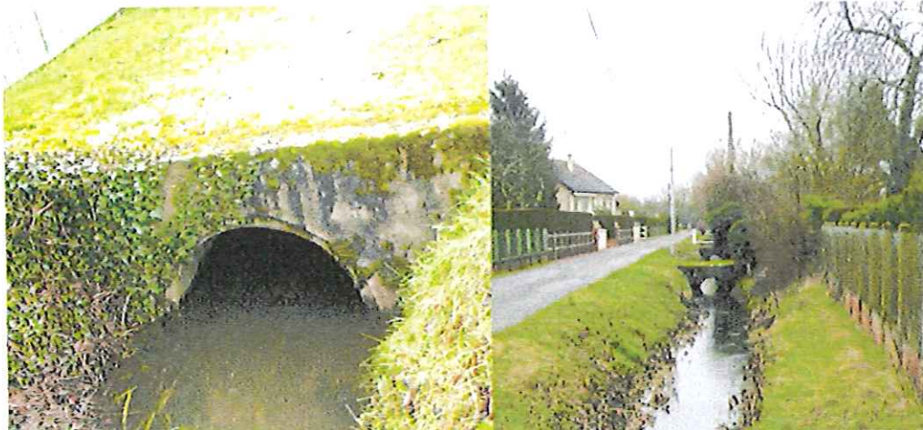
Figure 15 : Vue des buses de 1000 mm
