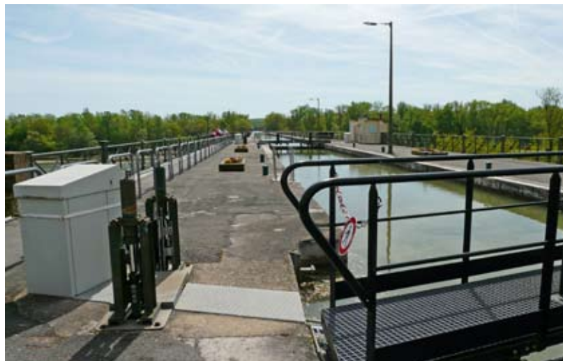
En 2010 : les ajouts successifs, les transformations et les réparations ont fait perdre toute unité et une partie de la qualité de l'ouvrage
