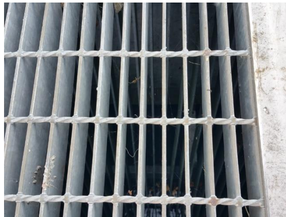
Figure 2-1 : Equipements existants – Dégrilleur
