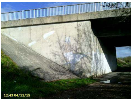
Figure 6 : culée du pont de la route départementale encastrée dans la digue, vue vers l'amont
