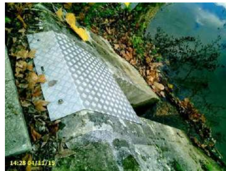
Figure 24 : ouvrage hydraulique traversant avec vanne crémaillère automatisée (pied de talus coté canal)
