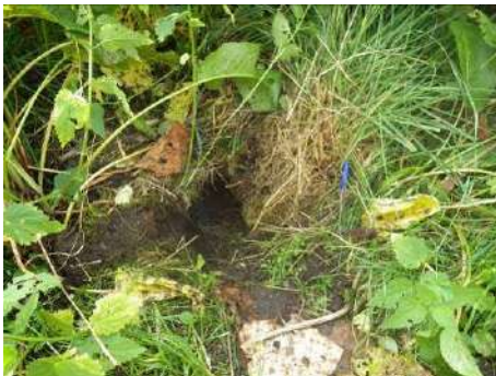
Figure 117 : Terrier de 10cm de diamètre au milieu de talus coté val (tronçon VTA n°7 – Val Ouest)
