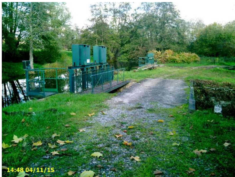
Figure 150 : Ouvrage de répartition de Coulanges en amont du système d'endiguement du val Ouest
