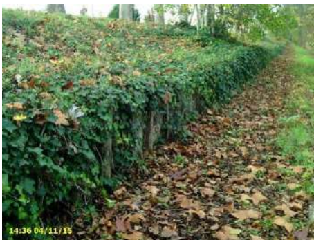
Figure 25 : Pieux en bois (avec géotextile) pour soutènement du milieu du talus coté canal vus vers l'amont (30m de long)
