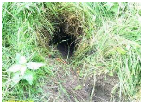
Figure 42 : terrier de 20cm de diamètre observé sur talus coté val sous la base du mur de soutènement - pk2750
