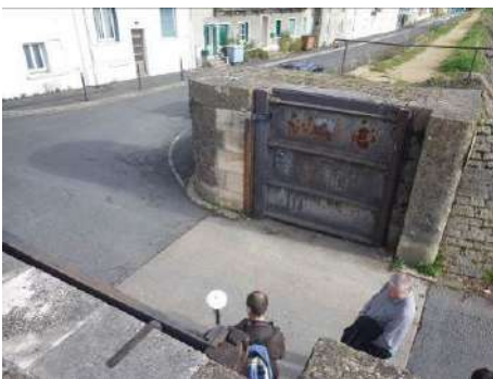
Figure 45 : fermeture de la digue de Médine au niveau des portes métalliques (vue vers l'amont)
