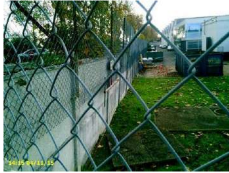
Figure 28 : mur de soutènement sur talus coté val vu vers l'aval au droit d'une usine
