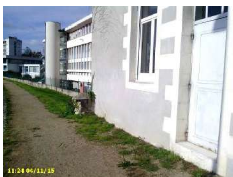
Figure 97 : Bâtiment de la DDT situé en aval de la porte de Médine encastré sur toute la hauteur de la digue (vu depuis la crête de l'ouvrage vers l'aval)
