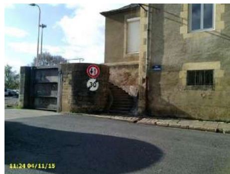
Figure 46 : raccordement de la porte au niveau de la maison encastrée (vu vers l'aval)
