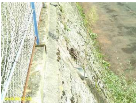
Figure 78 : Pt75 - Ouvrage hydraulique ouvert à travers le talus coté Loire de la digue de Médine (eaux pluviales ?) – fil d'eau 178.21mNGF
