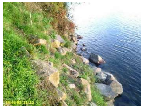
Figure 9 : protection de la berge en enrochements libres avec quelques blocs déstabilisés
