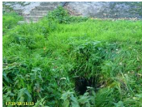
Figure 119 : Terrier de diamètre supérieur à 30cm sous parement bétonné (tronçon VTA n°1)
