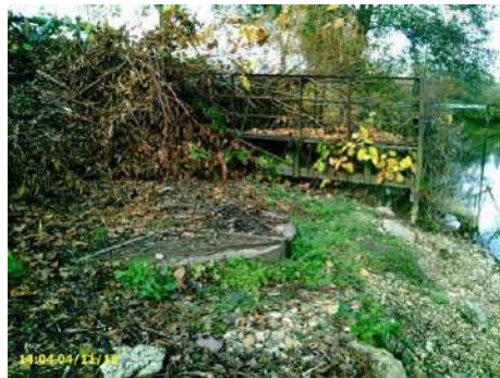
Figure 30 : station de pompage sur le bas de talus coté canal de dérivation (clapet étanche ?)
