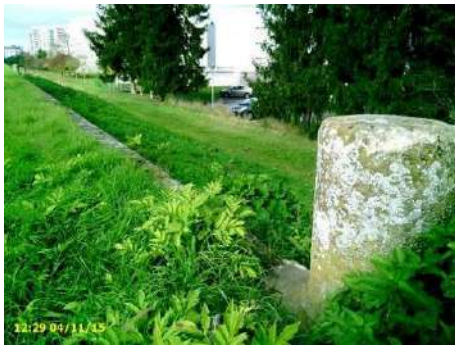
Figure 105 : Mur de soutènement en haut de talus coté val (vu vers l'aval) près de la rue du 8 mai 1945
