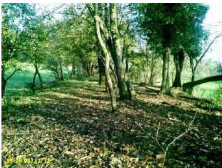
Figure 4 : vue vers l'amont de la crête de digue de la Maison Rouge avec présence de végétation ligneuse
