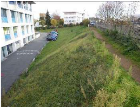
Figure 49 : talus coté val avec perré visible sous terre végétale (vu vers l'amont)
