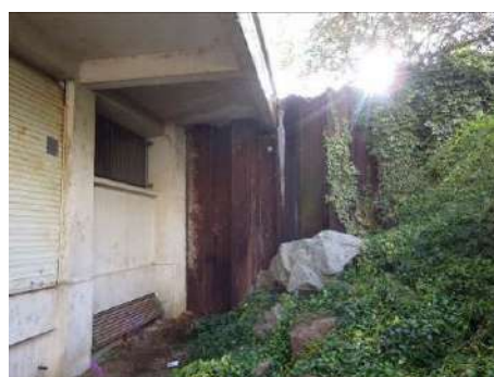
Figure 100 : Raccordement aval de la Maison de la Culture avec palplanches sur talus côté val – pk4150
