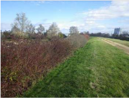
Figure 31 : digue vue vers l'amont avec végétation arbustive en milieu de talus coté val
