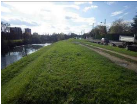
Figure 65 : vue vers l'aval de la levée rive droite du canal avec enrochements empêchant accès
