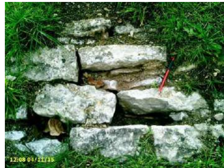
Figure 122 : Déjoints du perré en pied de talus coté val (levée St-Eloi 1ère section)
