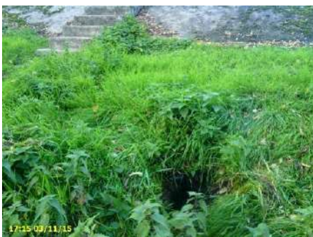
Figure 8 : terrier de diamètre supérieur à 30cm en milieu de talus coté Loire (sous parement bétonné)
