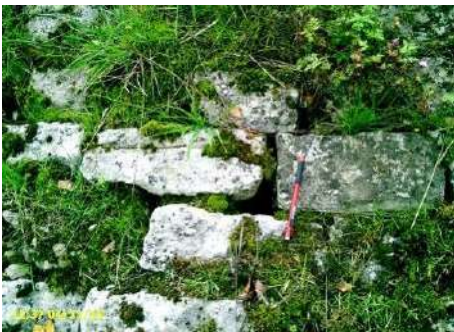
Figure 39 : déjoints du perré en pied de talus coté val
