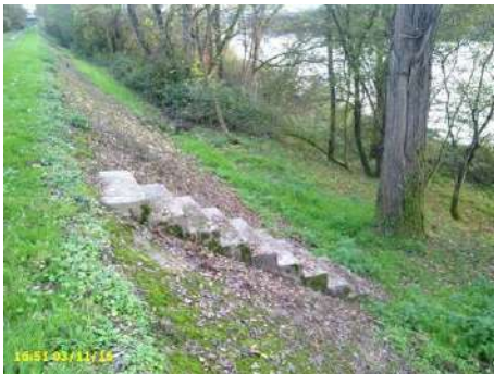
Figure 6 : parement bétonné sur le haut du talus coté Loire avec escalier en béton (vu vers l'amont) et végétation arbustive en pied de talus
