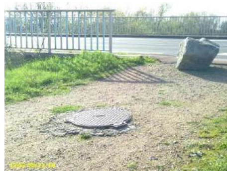
Figure 66 : bloc empêchant accès levée du canal rive droite en amont du pont de la départementale
