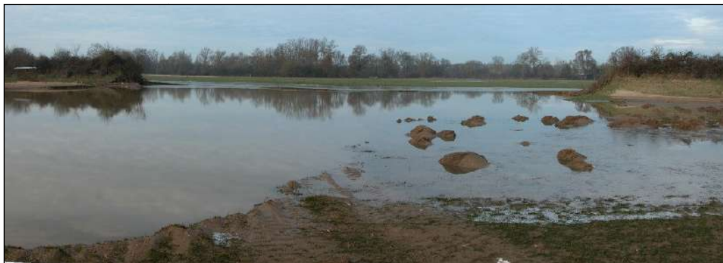
Figure 174 : Brèche dans la digue de Mauboux à Livry (58) - Crue de 2003 (crédit photo DREAL Centre)
