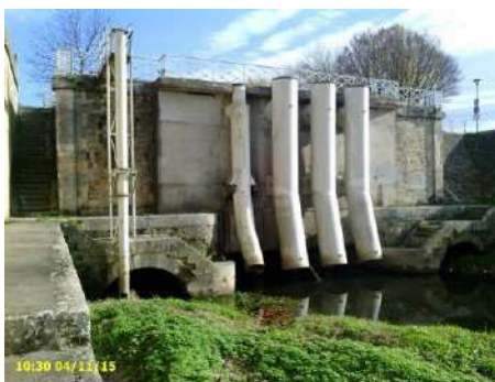
Figure 79 : Pt74 - Station d'exhaure du pont mal Placé constituée d'un système de 4 pompes et vannages automatisés (pour rejet des eaux depuis le val vers la Loire)
