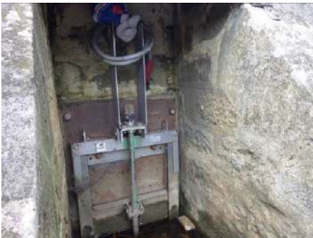
Figure 72 : Pt77 - Ouvrage hydraulique avec vanne crémaillère automatisé (permettant écoulement dans le ruisseau de l'Eperon) sur la levée rive droite du canal de dérivation – fil d'eau 177.62mNGF
