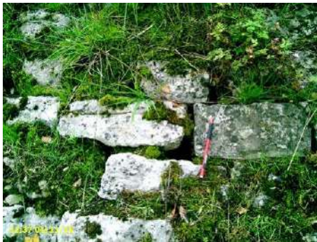
Figure 121 : Déjoints du perré en pied de talus coté val (levée St-Eloi 1ère section)
