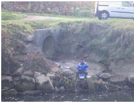
Figure 75 : Pt163 - Buse en béton de diamètre 1500mm permettant l'écoulement des eaux pluviales vers la Loire. Il est précisé que la fermeture de cet ouvrage est assurée par la vanne de l'exutoire du pluvial gravitaire du centre des expositions dit « vanne du karting »
