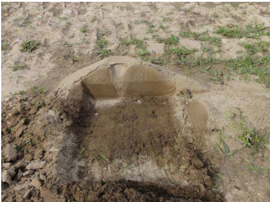
Figure 177 : Coupe d'un sand Boil derrière les digues de l'Agly – crue du 6 mars 2013 – (photo : DDT des Pyrénées-Orientales)
