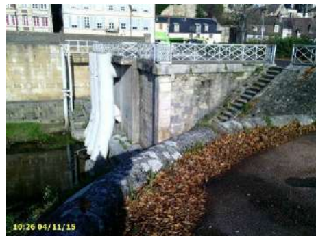
Figure 54 : station de pompage avec conduites de rejets vers la Loire
