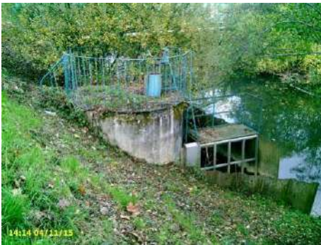
Figure 29 : station de pompage sur le bas de talus coté canal de dérivation (clapet étanche ?)
