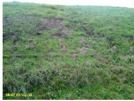
Figure 15 : glissement observé sur talus coté canal
