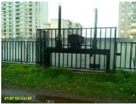
Figure 76 : Pt73 - Ouvrage hydraulique avec martelière coté val (levée St-Eloi 2ème section) – station de relevage des eaux de la Baratte
