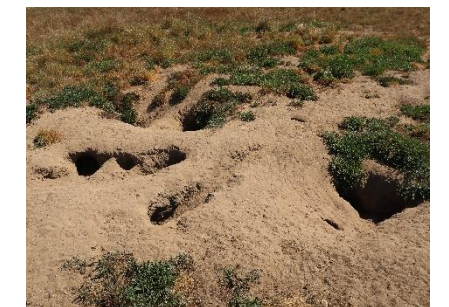
Trous au sein de la partie C Source : ARTIFEX 08/2022
