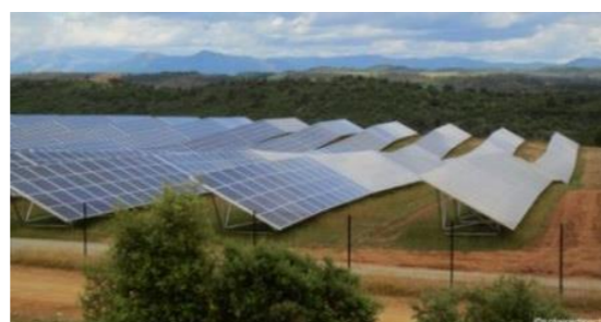
Photographie 1 : Exemple d'installation photovoltaïque au sol
