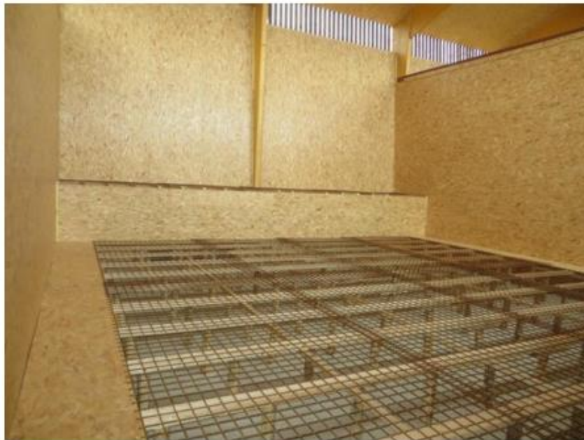
Figure 23 : Exemple de cellules de séchage fourrage
