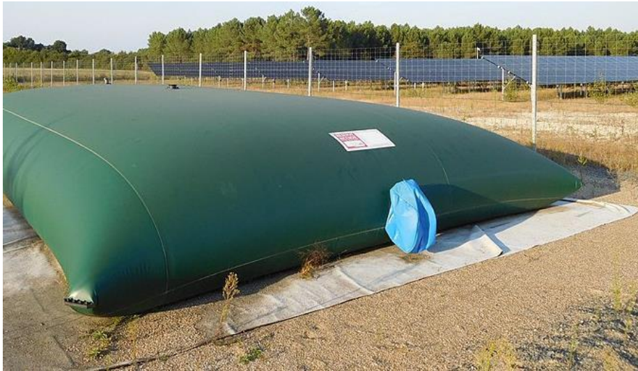
Figure 8 - réserve incendie souple
