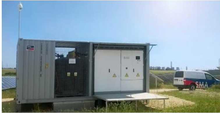
Figure 7 - exemple de Poste de transformation
