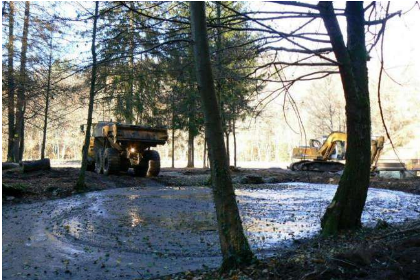
Figure 88 : Vue de la fosse de réception des sédiments curés, créée en aval du chenal de l'EVC
