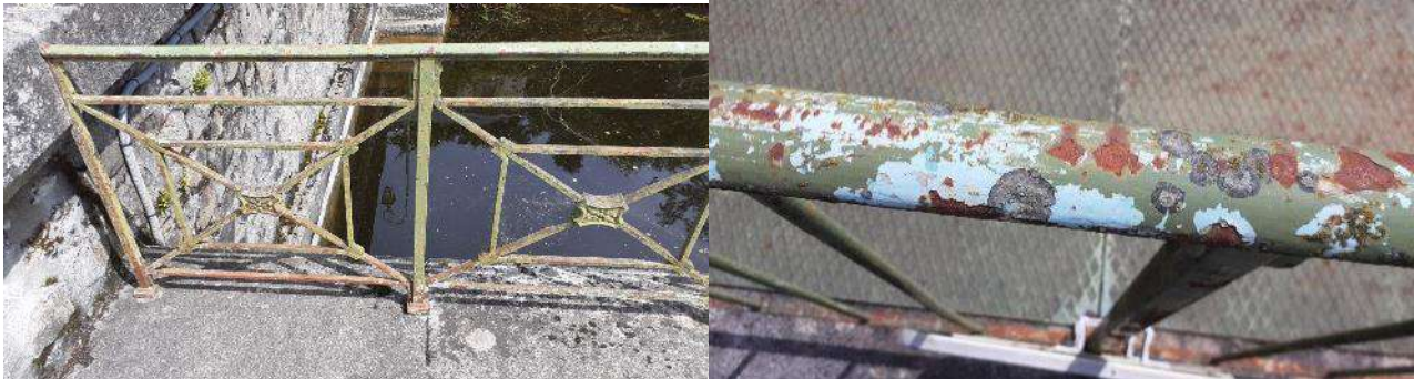
Figure 124 : Des garde-corps dont le vieillissement a fragilisé la structure et altéré les couleurs (Source : EGIS)
