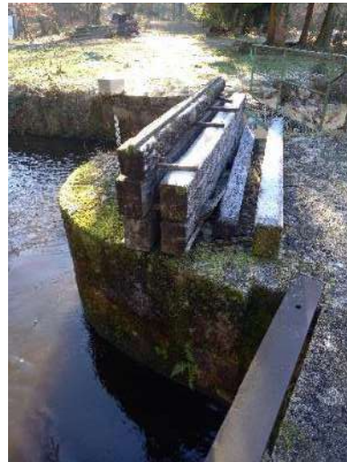
Batardeaux déjà présents sur le seuil
