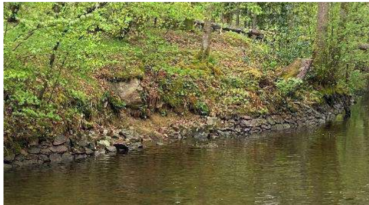
Figure 117 : Epanchoir n°1 (aval tour de prise) : Berge dégradée
