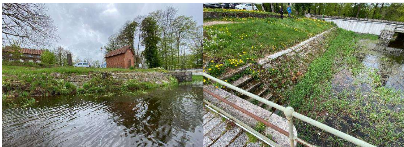
Figure 122 : Perré maçonné rive gauche
