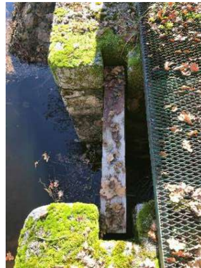
Vanne de sortie de ce bassin (batardée)
