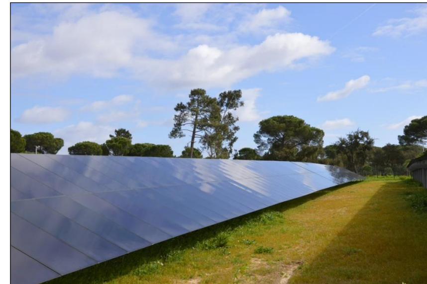
Figure 15 : Exemple d'une rangée de modules
