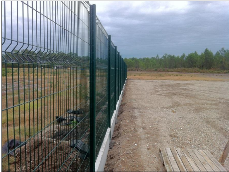
Figure 23 : Exemple de clôture autour d'une centrale
