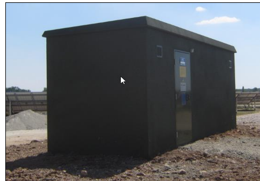
Figure 17 : Exemple de poste de conversion « indoor »
