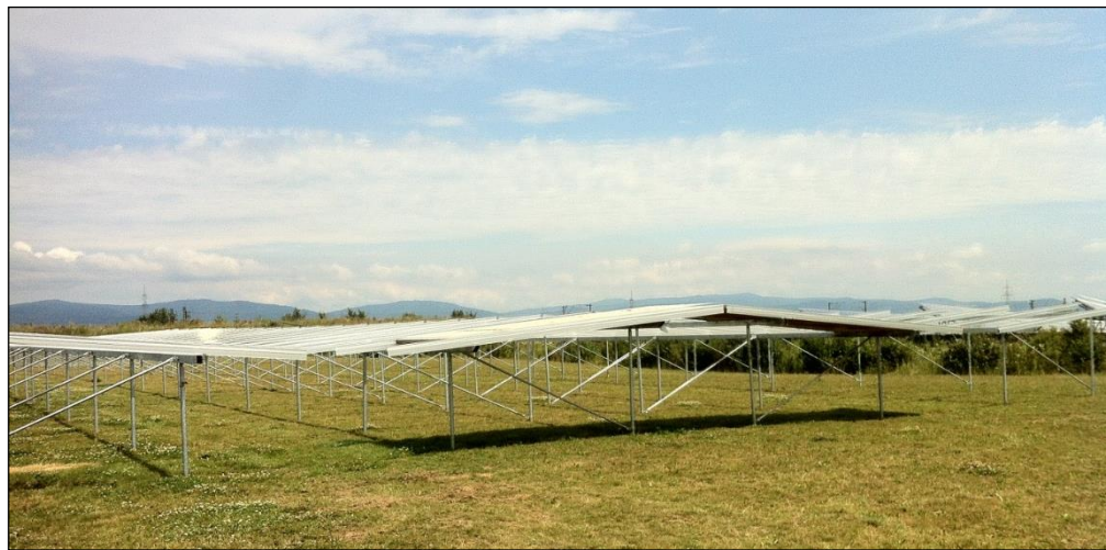
Figure 27 : Structure de tables dans une orientation est-ouest
