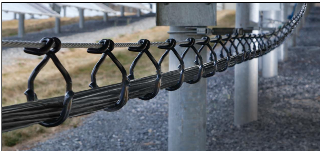
Figure 16 : Exemple de câblage hors-sol (Source: CAB Solar)
