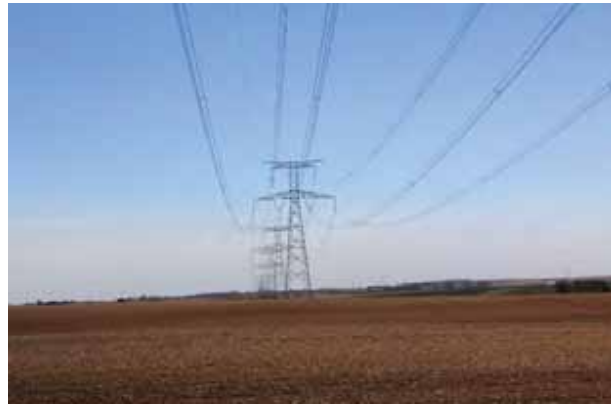
Photo 54 : Prise de vue n°9 : Lignes électriques THT incluses dans la partie Sud de l'aire d'étude rapprochée
