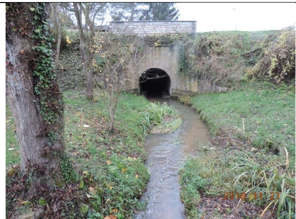
Figure 12 : Vue du ruisseau des Frossards – amont immédiat de l'ouvrage sous la RD907
